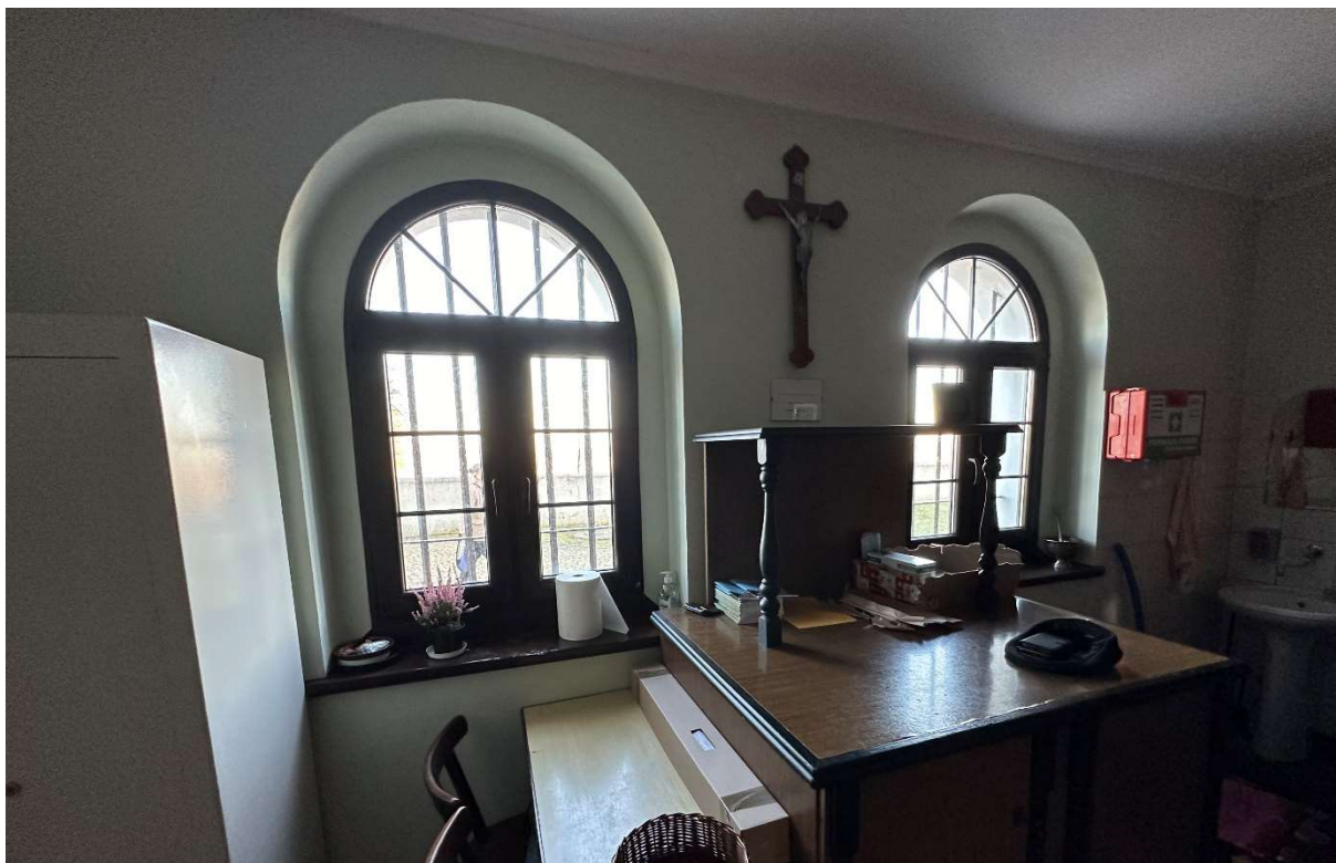
Fot. 3. Okna plastikowe w pomieszczeniu zakrystii przeznaczone do wymiany.
