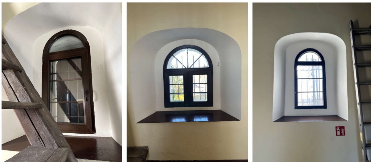
Fot. 1 A, B, C. Okna plastikowe w wieży przeznaczone do wymiany.
