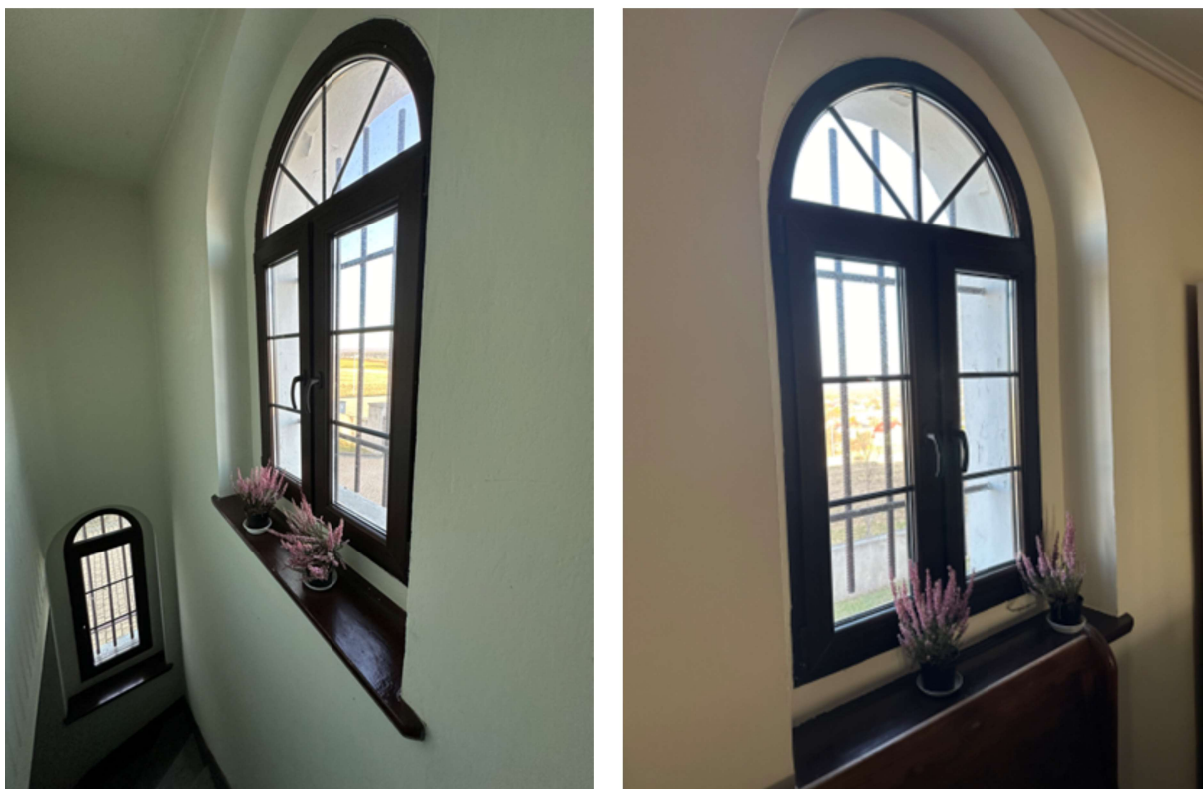
Fot. 2 A, B. Okna plastikowe w pomieszczeniu nad zakrystią przeznaczone do wymiany.
