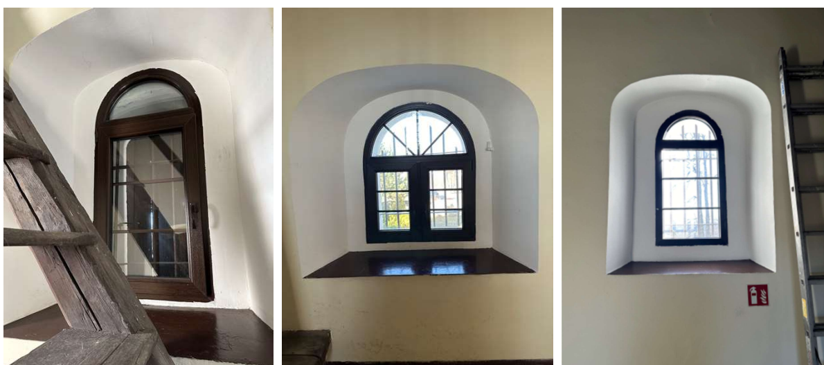
Fot. 25 A, B, C. Okna plastikowe w wieży przeznaczone do wymiany.
